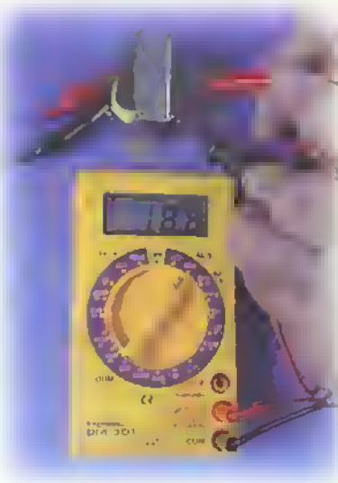
Figura 3.19. Medido de voltaje en corriente alterna en el secundario de un transformador
